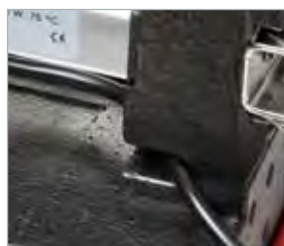
Kabelführung cable channel
